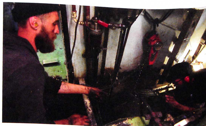
Anders Widell i maskinrummet på Estelle.
